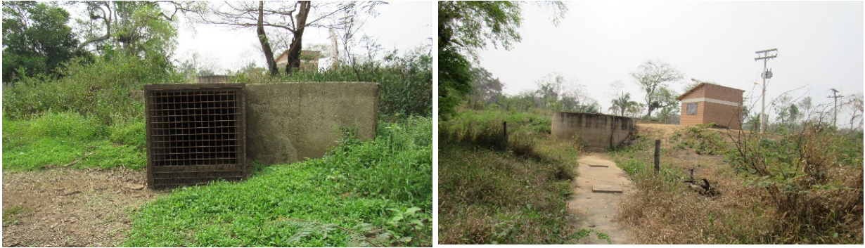
Figura 3. Sistema de captación de agua ubicado en el cauce del río Zapocó.
